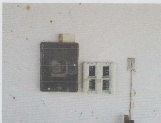
Instalações elétricas não estão isoladas
