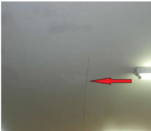
Fotos 10: Forros com rachaduras (sala de aula)
