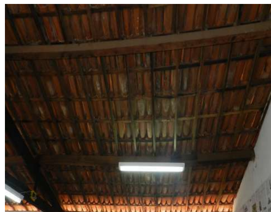
Foto 12: deformações importantes no madeiramento
