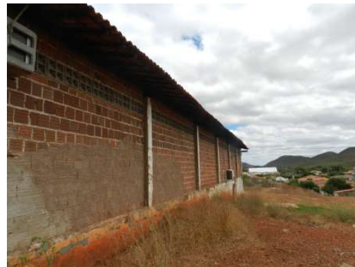
Foto 21: alvenaria posterior sem revestimento
