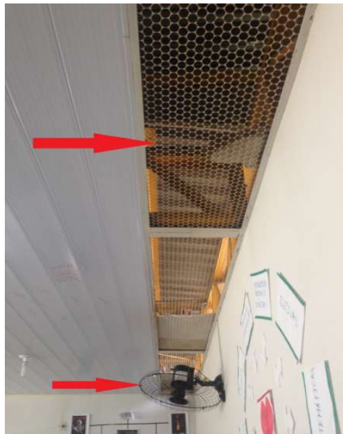
Foto 2: grelhas com abertura no forro de PVC e ventiladores instalados nas salas de aula
